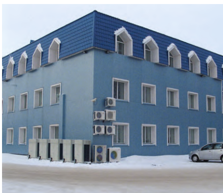
Офисный центр г. Сыктывкар Мультизональные системы Dantex
