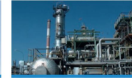
Месторождение «Тенгизшевройл», респ. Казахстан, компрессорно-конденсаторные блоки DANTEX
