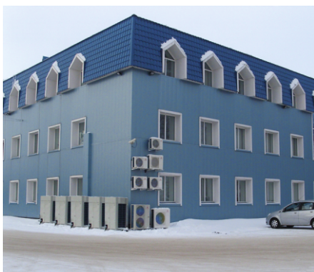
Офисный центр г. Сыктывкар Мультизональные системы Dantex
